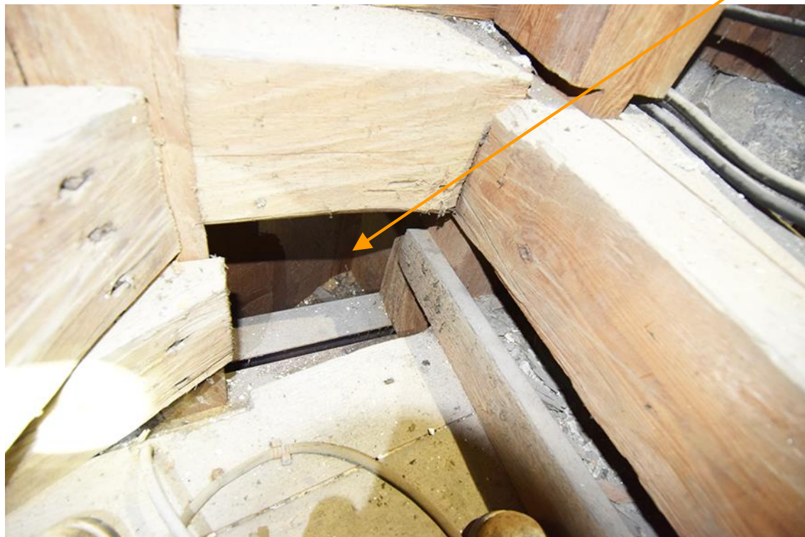
3: vgl. Bild 3: Doppel-T-Träger unter Schwell-/Riegelebene. Im Mauerwerk Hauptschiff Süd verankert, Abfangung für Orgeltisch.
