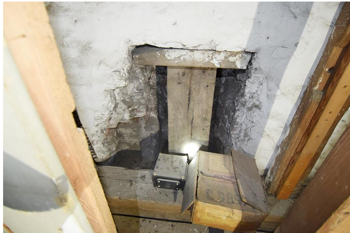
3: Westseite Mittelbau/Südflügel. Ausragender Tragbalken im Mauerwerk des Turmes mit Futterhölzern „eingekeilt“. Vgl. Skizze rechts am Blattrand.
