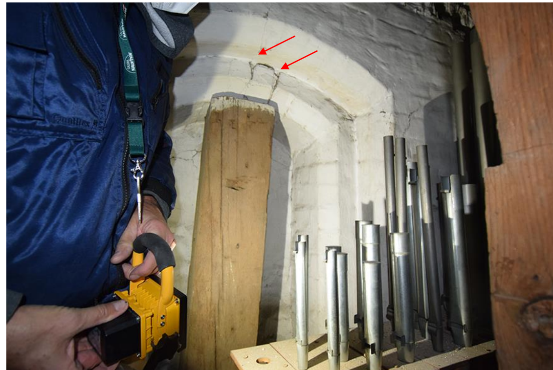
4: Vertikale Auskeilung Kragbalken am Südseitenschiff, in Mauernische Triforium. Oberhalb Rissbildung im Mauerwerk.
