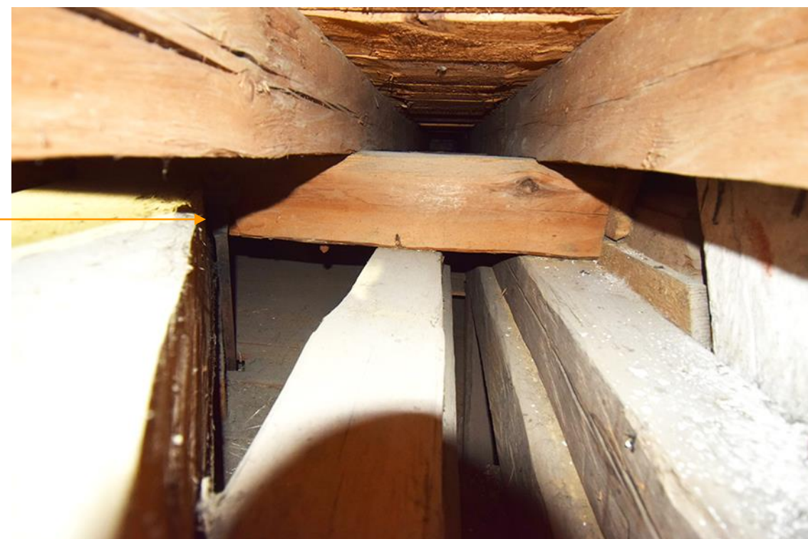
3: Blick nach Westen. Rechts Nordseite des Hauptschiffes, links im Anschnitt der schräge Tragbalken mit der Eisensicherung, vgl. Bild 2.
