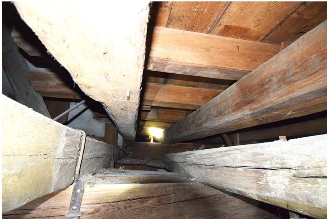
1: Blick nach N, Balkenlagen am Mittelbau. Unten Tragwerk des Baldachins, oben die mittlere und obere Lage des Unterbaus.
