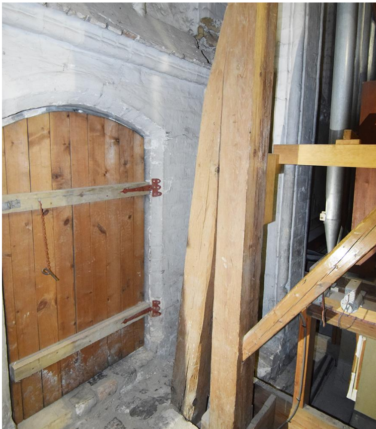
3: Nordseite, Ständerachse 2 v.W., typische Ausbildung: Offenbar waren alle Außenständer an der Nord- und Südseite ehemals auf die Mauerbank
