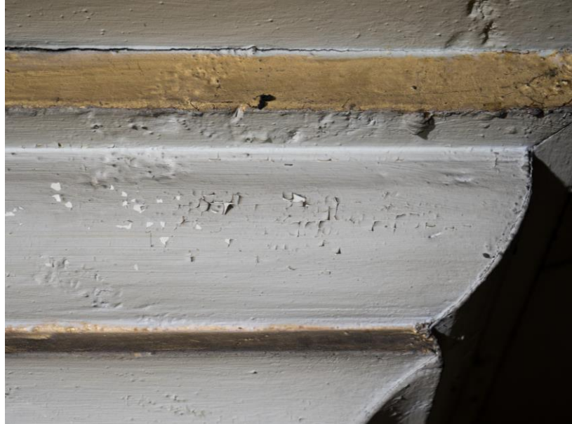
kleinteiliger Bereich am Orgelprospekt mit aufstehender ölhaltiger Sichtfassung
