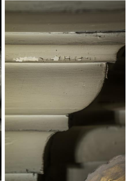
abgängige Fassung an einem Gesims
