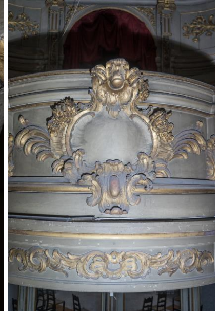
Fürstenloge mit Fehlstellen in der Sichtfassung von 1841 - 1843
