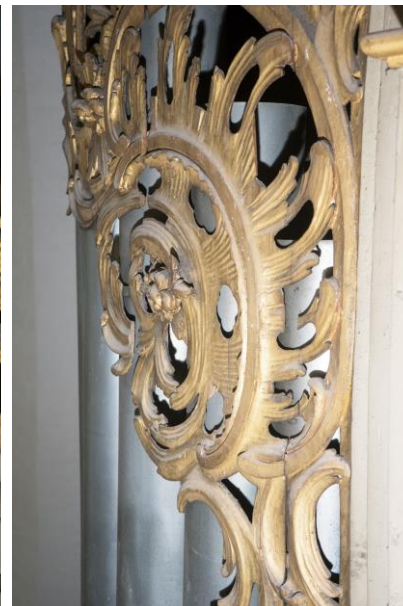
Bohrlöcher von Holzschädlingen
